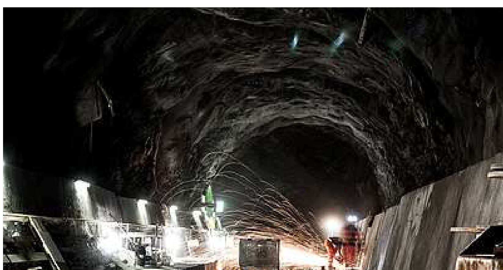
Underground Future Lab - Centro de innovación de relevancia nacional que lidera la digitalización de túneles
